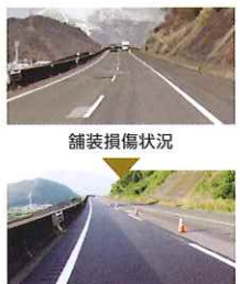
舗装損傷状況 補修後イメージ
